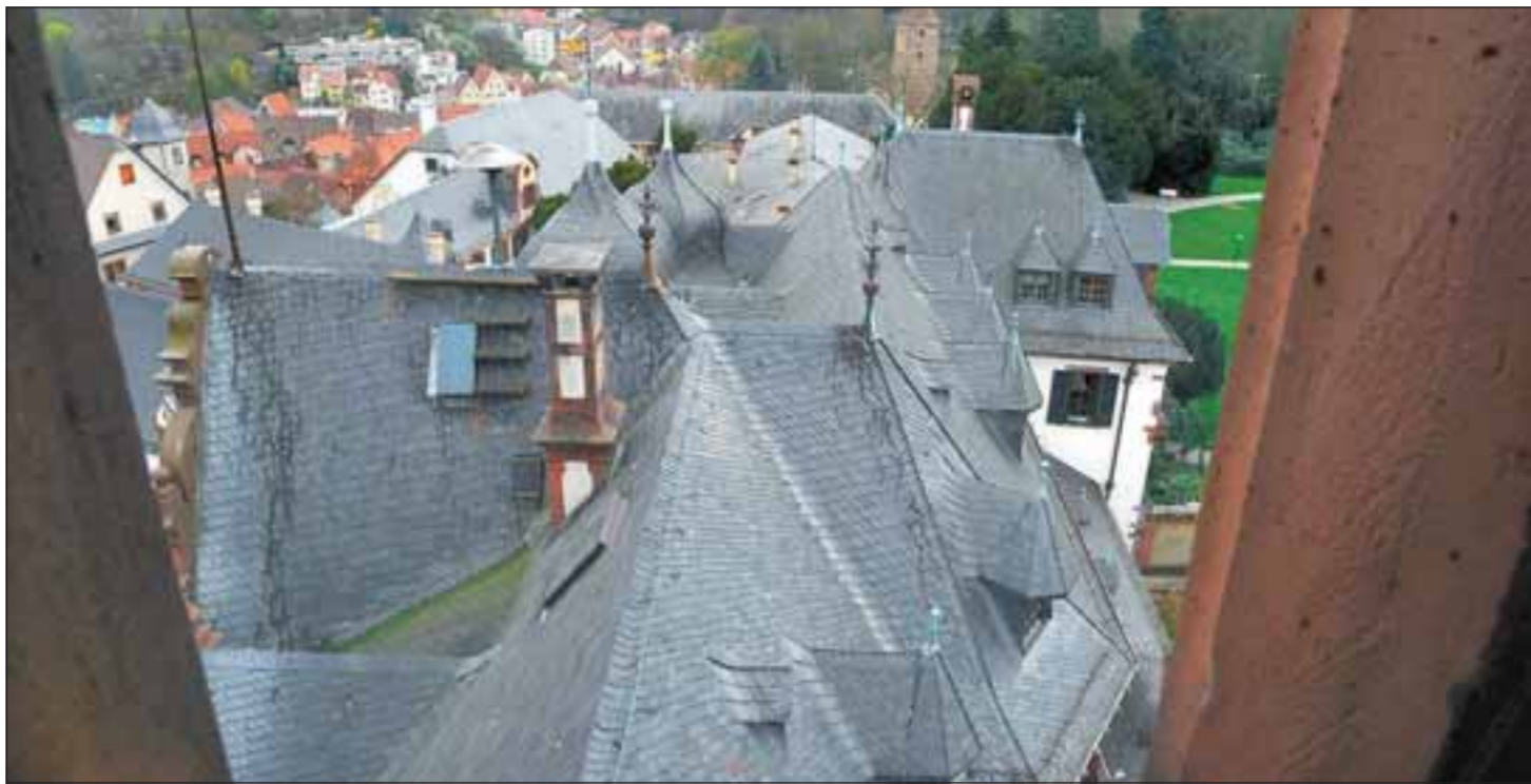
Wie der städtische Haushalt ist auch das Dach des Rathauses ein Sanierungsfall. Foto: Dorn
